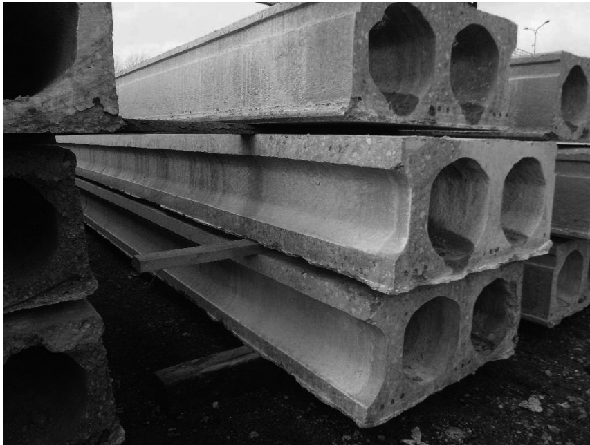
Fot.1.2 Stan krawędzi płyt przy powierzchniach ciętych
