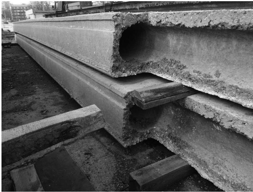
Fot.1.3 Stan krawędzi wycięć wykonanych na mokro
