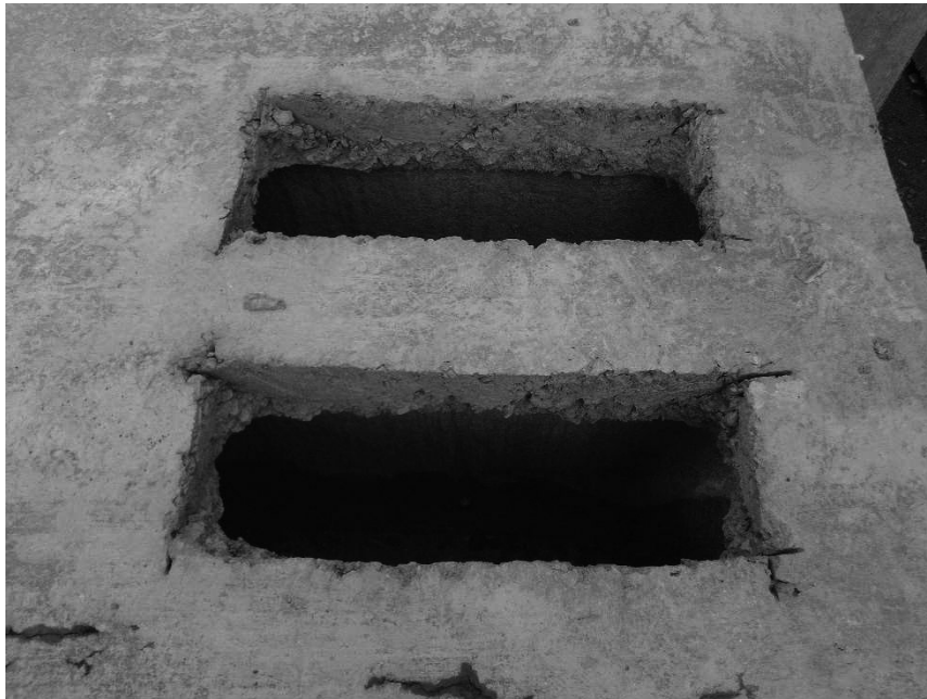
Fot.1.4 Stan otworów wykonanych na mokro
